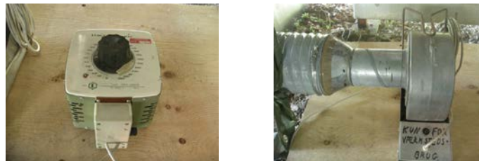
Figur 9. Trinløs spændingsregulering, Lübcke Vario type R54-260B / 0-260 Volt (venstre) og ventilator (højre).
